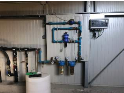
Станция хлорирования воды
