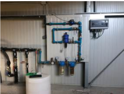
Станция хлорирования воды
