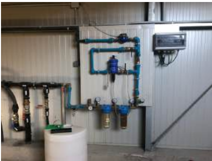
Станция хлорирования воды
