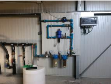
Trạm clo hóa nước
