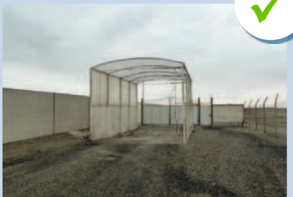
Túnel de desinfección para vehículos
