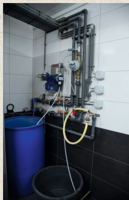
Estação de tratamento de água
