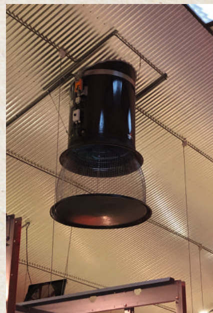
Sistema de controlo ambiental por pressão
