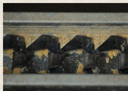
Niveau trop bas
