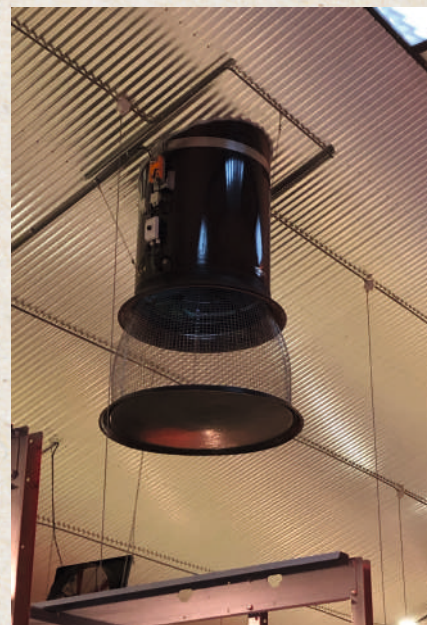
Système de ventilation dans le poulailler d'élevage en plein air.
