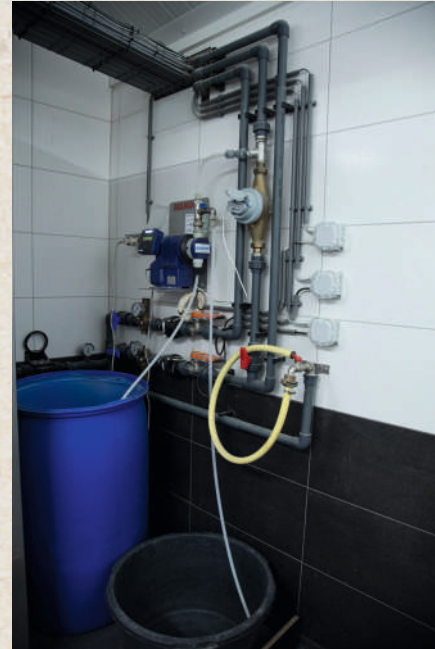
Station de traitement de l'eau
