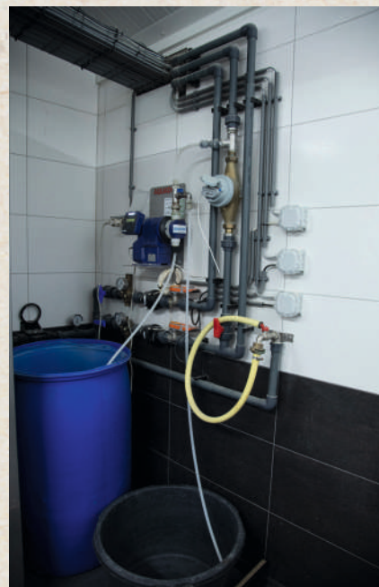
Estación de saneamiento de agua
