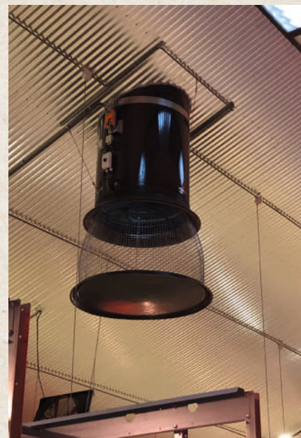
Sistema de control de clima en nave de postura Free range
