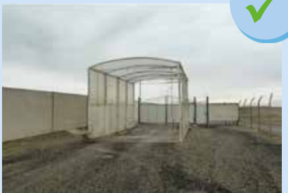
Tunnel de désinfection pour les véhicules
