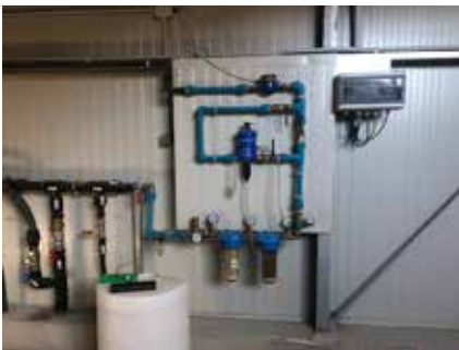
محطة معالجة المياه بالكلور
