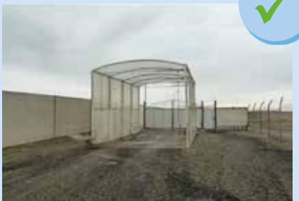
Arco di disinfezione
