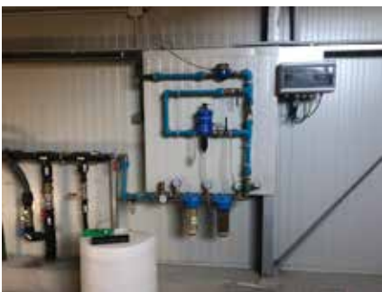
محطة معالجة المياه بالكلور
