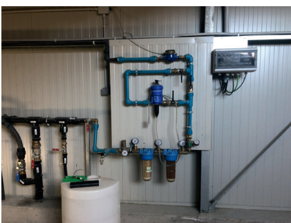
محطة معالجة المياه بالكلور
