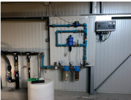
محطة معالجة المياه بالكلور
