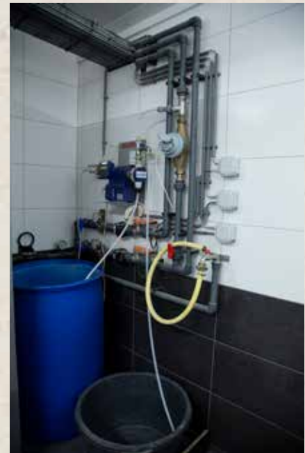
Estación de saneamiento de agua
