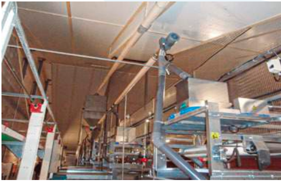
Immagine 3. Esempio di un impianto di alimentazione adeguatamente dimensionato
