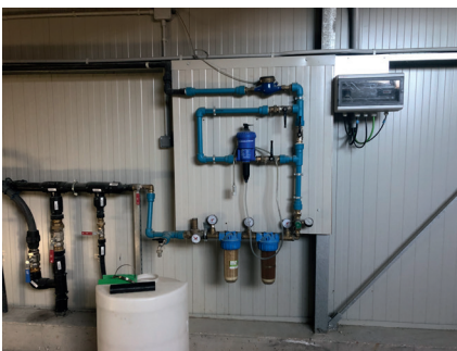
محطة معالجة المياه بالكلور
